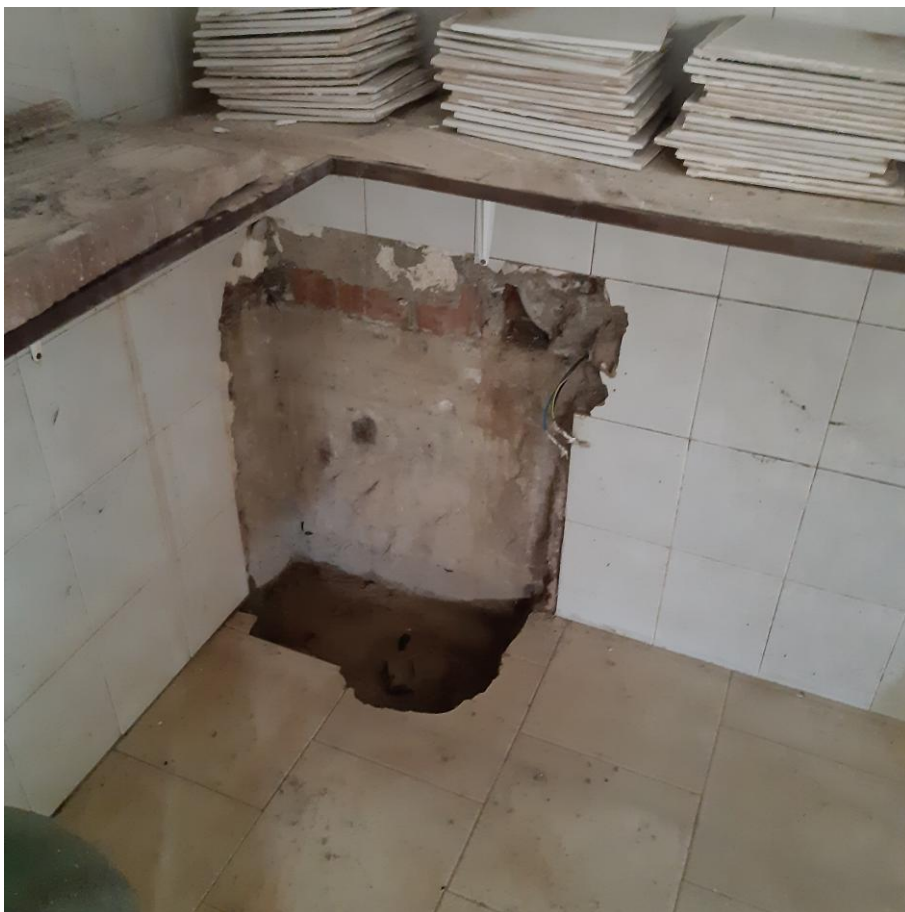
Foto 33: saggio presente nel locale pluriuso (foto giugno 2020)
