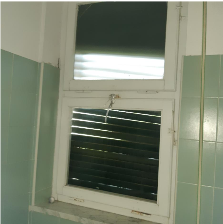
Foto 36: particolare infissi vetusti in legno (foto giugno 2020)
