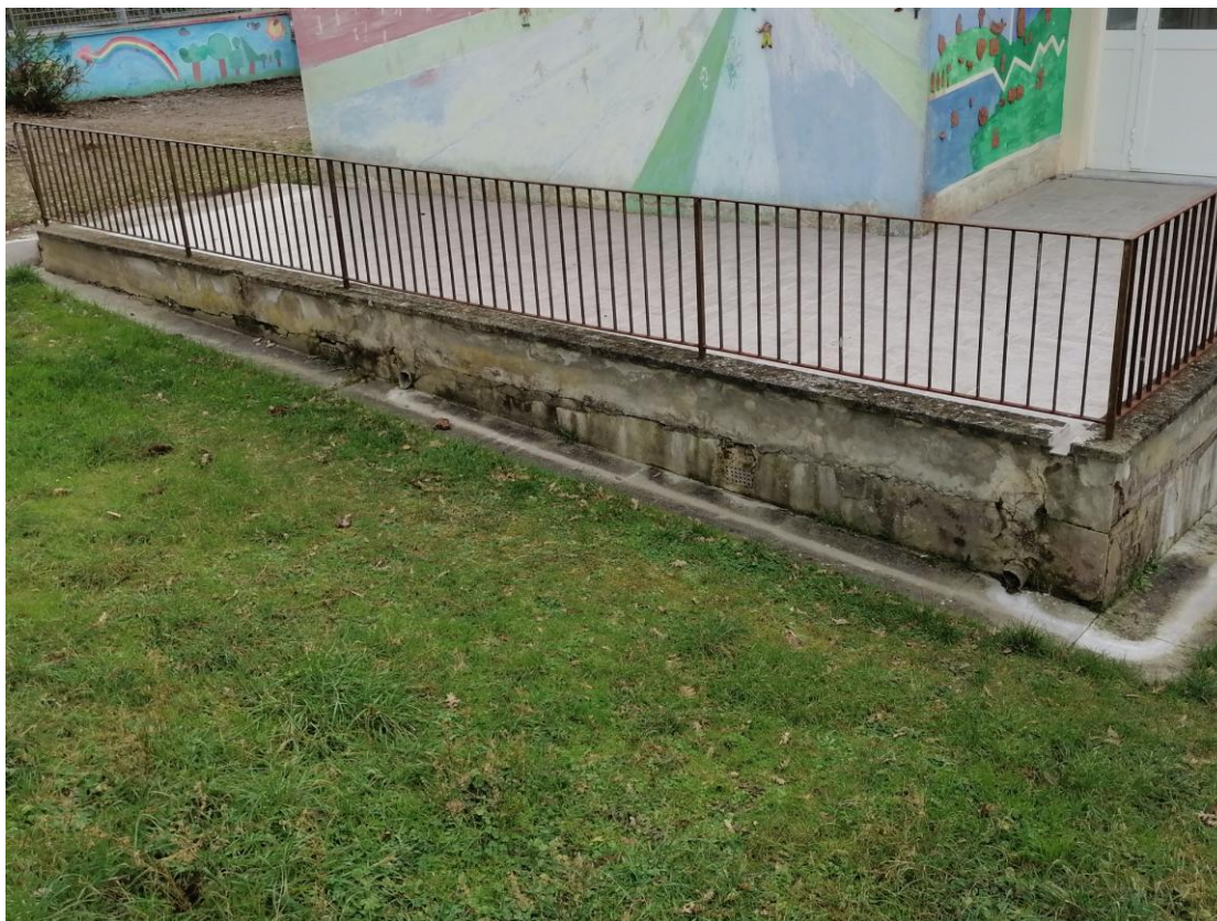
Foto 9: rampa con ringhiera e muretto degradati
