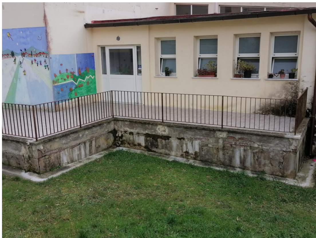
Foto 10: rampa e muretto degradati
