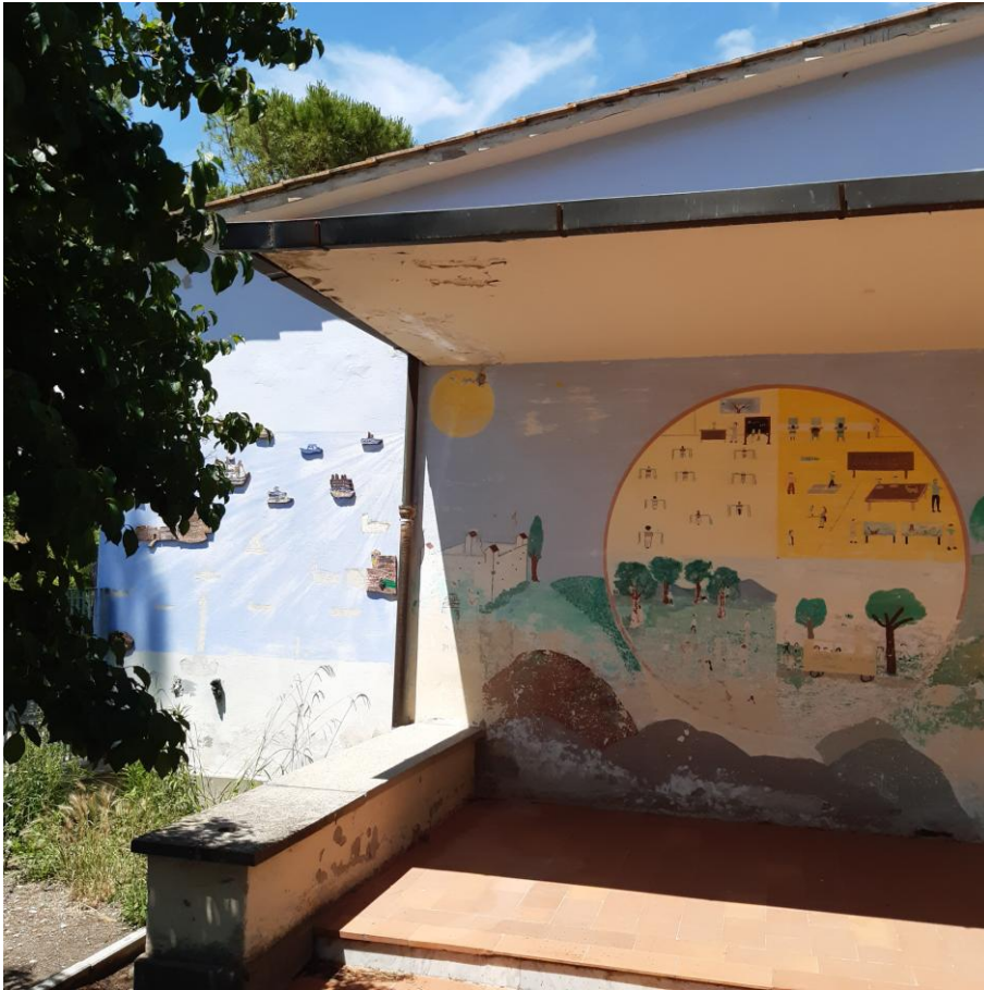
Foto 5: Prospetto Est – intonaci ammalorati (foto giugno 2020)
